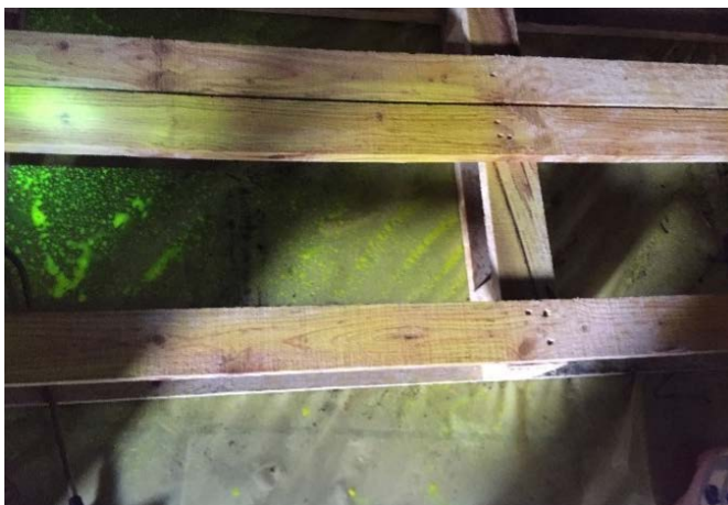
Fluoreszenz bei Beleuchtung mit UV-Lampe auf Holz und Kunststoff im Dachraum
